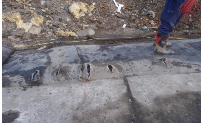
写真-1. 1 掘削工事中の遮光マット損傷箇所
