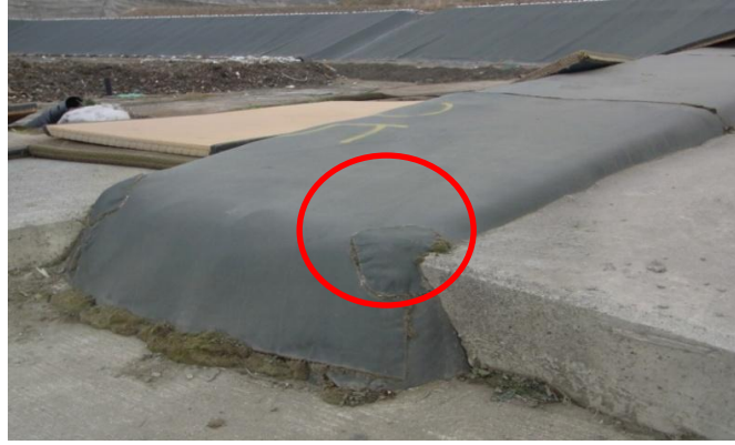
写真－2. 1 漏水検知箇所の類似箇所
