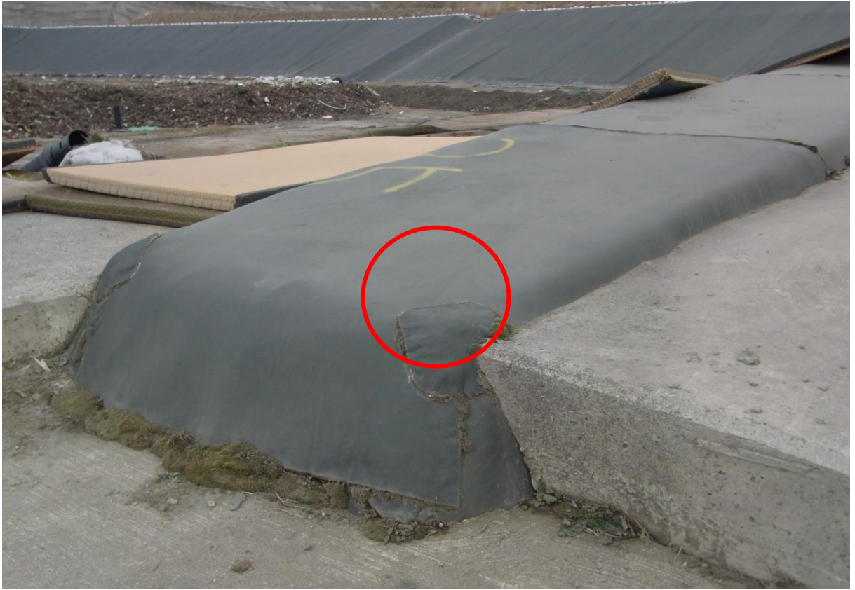
漏水検知箇所と類似箇所の写真
