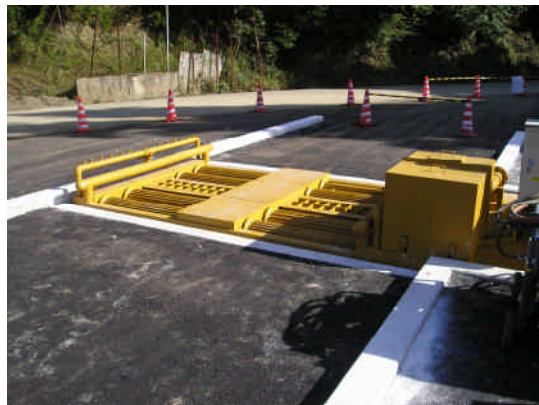
工事車両洗車施設
